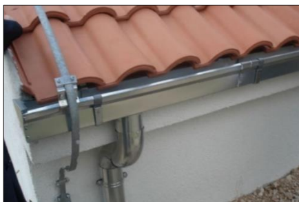
Čelična traka spojena na metalni oluk
